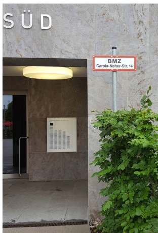
Abb. 32 Beschilderung einer Brandmeldeanlage vor einem Gebäude
