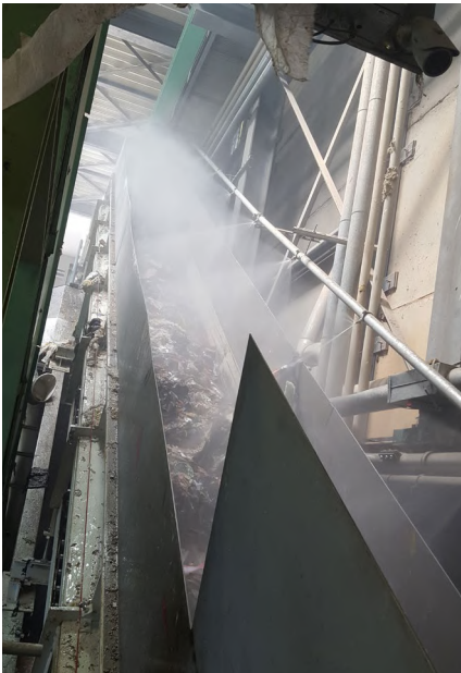
Abb. 60 Sprühwasserlöschanlage in Betrieb
