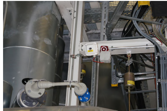
Abb. 34 Flammenmelder an einer Industrieanlage
