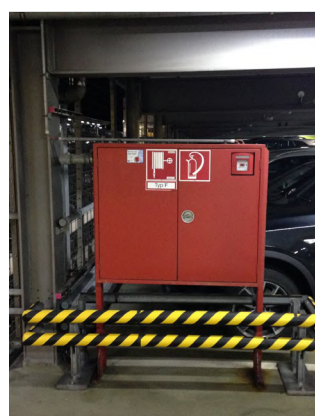
Abb. 50 Vor Beschädigungen und Witterungseinflüssen geschützte Feuerlöscheinrichtungen
