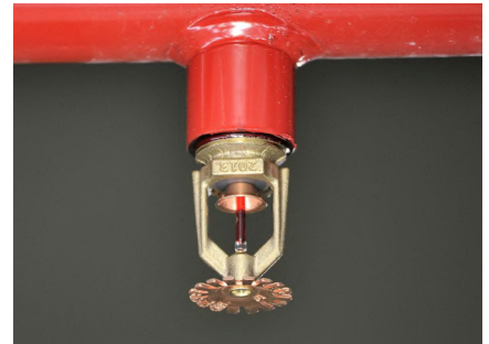
Abb. 58 Installierter Sprinkler im Rohrnetz
