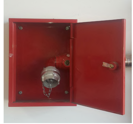
Abb. 65 Entnahmestelle einer trockenen Löschwasserleitung
