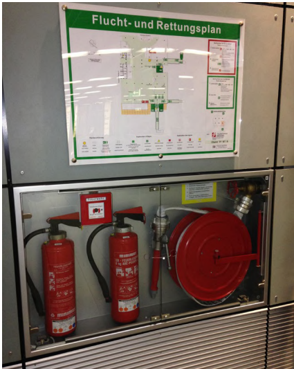
Abb. 53 Bereitstellung von Feuerlösch-einrichtungen
