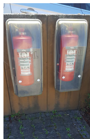
Abb. 51 Vor Witterungseinflüssen geschützte Feuerlöscher
