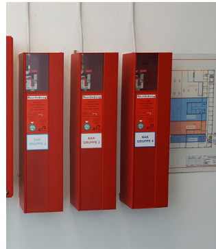
Abb. 41 Auslöseeinrichtung Rauch und Wärmeabzug
