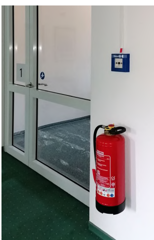
Abb. 49 Gut sichtbarer und leicht erreichbarer Feuerlöscher
