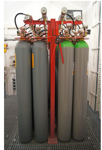
Abb. 62 Flaschenstation einer Gaslöschanlage
