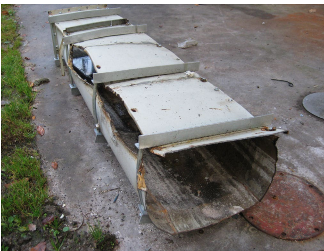
Abb. 29 Zerstörte Filterelemente (Quelle: BGN)
