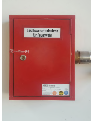
Abb. 64 Entnahmestelle einer trockenen Löschwasserleitung
