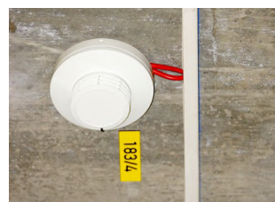
Abb. 33 Rauchmelder an einer Raumdecke
