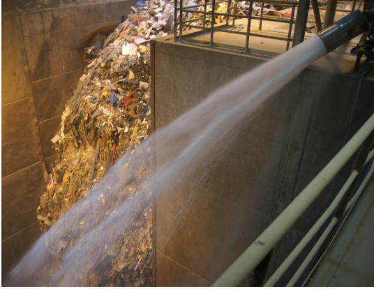
Abb. 63 Stationäre Schaumlöschanlage in einem Abfallbunker
