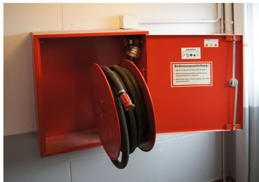
Abb. 67 Wandhydrant als Selbsthilfeeinrichtung
