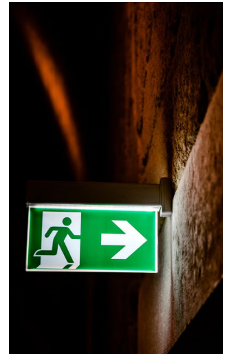
Abb. 19 Notlichtsystem als Sicherheits- und Rettungszeichenleuchten
